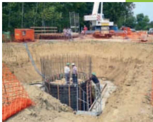
Station de relèvement, septembre 2008
